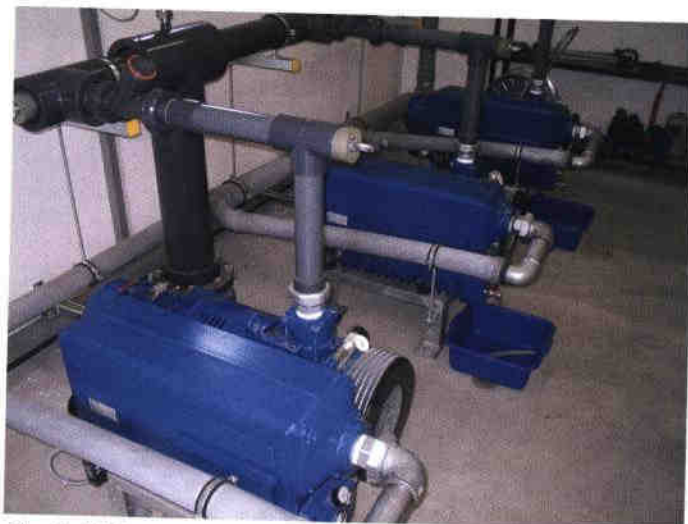
Obr. 2: Vývěvy systému podtlakové kanalizace Prostějov-Bedihošť jsou umístěny v samostatné provozní budově
