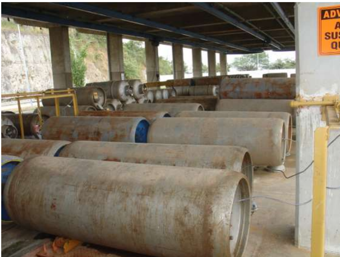
Obr. 03 Sklad nádob na plynný chlor
